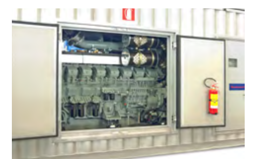
Container 60/65 dbA - 40"HC 2000 kVA Mitsubishi
