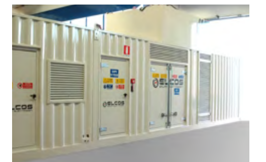
Container 70/75 dbA - 40"HC 1700 kVA Perkins
